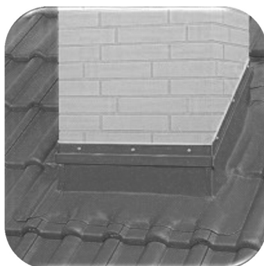
15.101 pav. Pilnai užsandarintas kaminas
